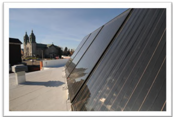
Modules solaires thermiques sur le toit de l'Écologis Karine O'Caïn (Lecompte, 2013)
